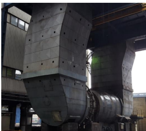
Rys. 1. Kanał spalin z wentylatorem wyciągowym osiowym nr 1
