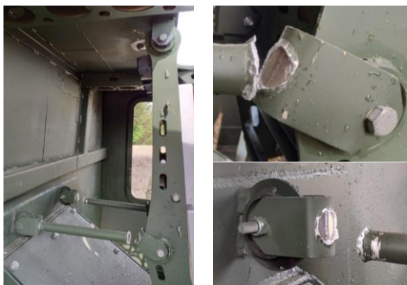
Rys. 4. Uszkodzenia mocowania fotela pasażera do ściany grodziowej
