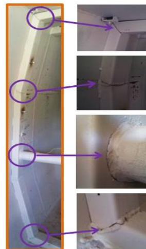
Rys. 7. Uszkodzenia poszycia szkieletowego
