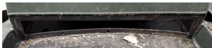
Rys. 6. Zerwane śruby pokrywy technicznej
